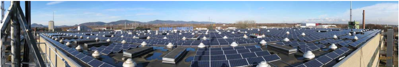
Anlage der Solar-Bürger-Genossenschaft auf einem ehemaligen Fabrikgelände in Landau, © B. Flieger
